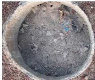
C : des déchets à l'intérieur d'un puits
