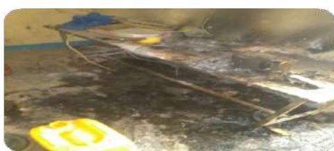
Figure 1: Logement d'enseignant incendié
