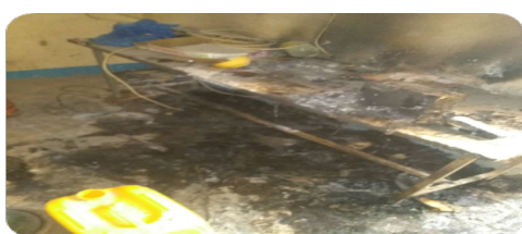
Figure 1: Logement d'enseignant incendié
